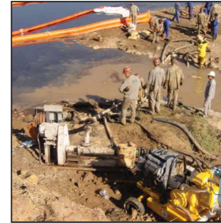
Bereinigung von Ölfällen (Venezuela)
