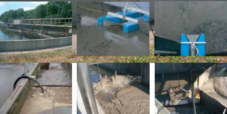
Einbaubeispiel in einem Sandfang-Gerinne
