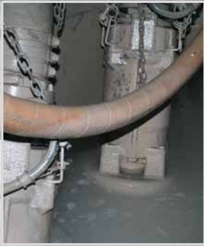
Selbst für ein ungeübtes Auge ist das sand- und kieshaltige, mit Betonit und Bohremulsionen versetzte Bergwasser zu erkennen. Eine Herausforderung für jede Abwasserpumpe
