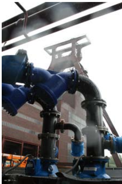
➔ SPT Tauchmotorpumpen mit Verrohrung
